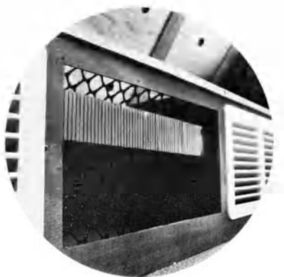
radiatorvärme med cirkulationspump och termostat i SMV
